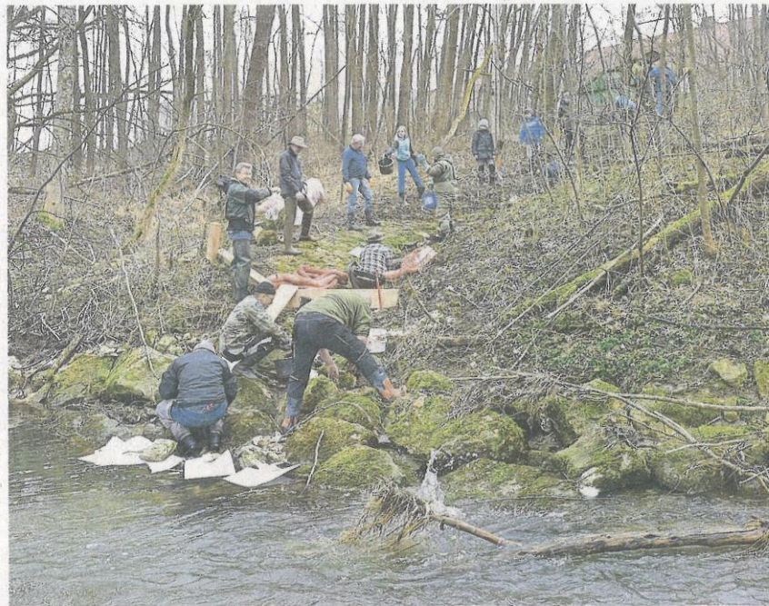
Gemeinsam nacharbeiten: In einer privaten Aktion säuberten rund 20 Freiwillige in Lengdorf das Gelände an der Isen, das nach einem Unfall mit Heizöl verunreinigt worden war.
